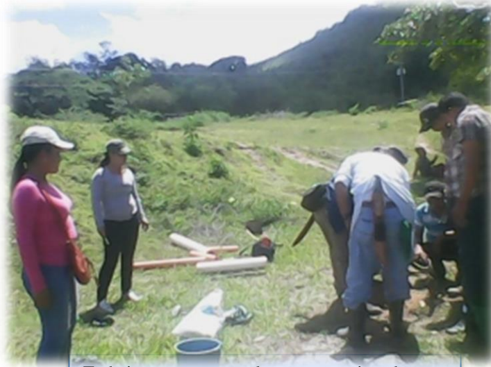
Trabajo en grupo en el terreno gestionado para la construcción del centro universitario.
