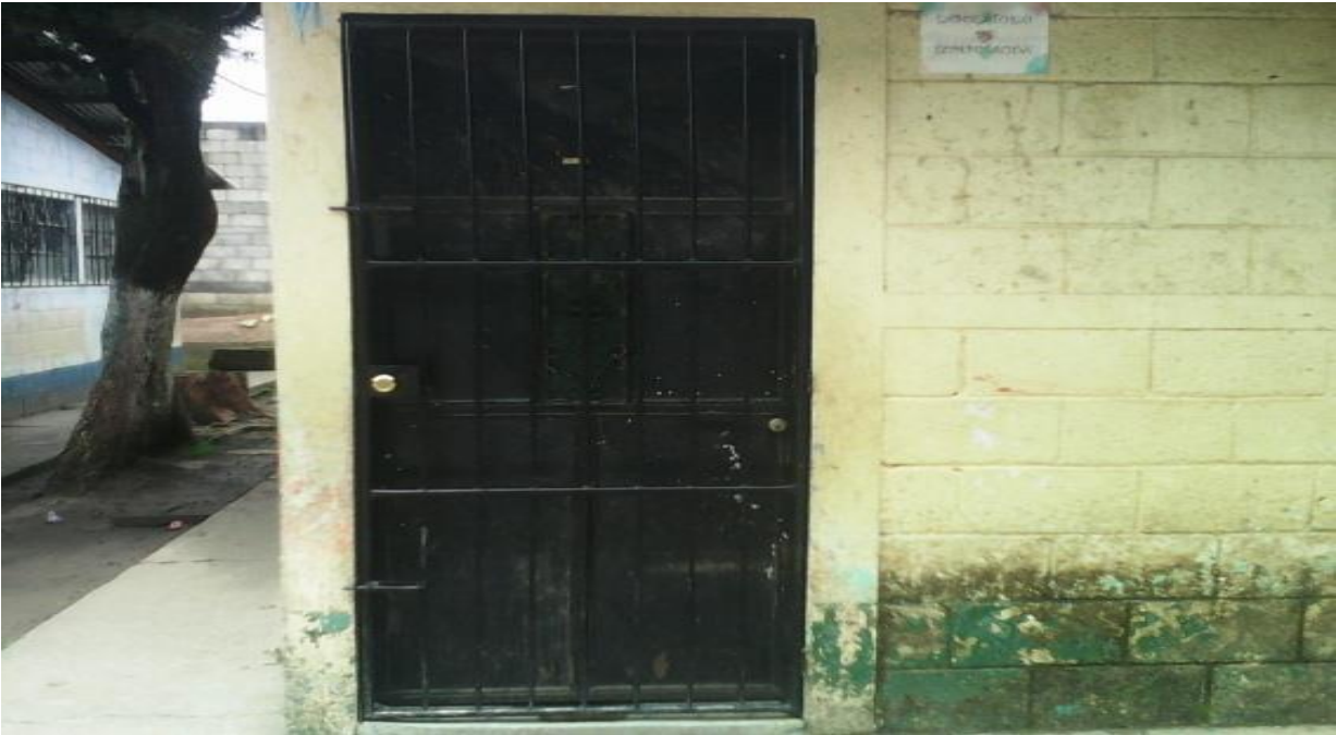
Paredes sin pintar
