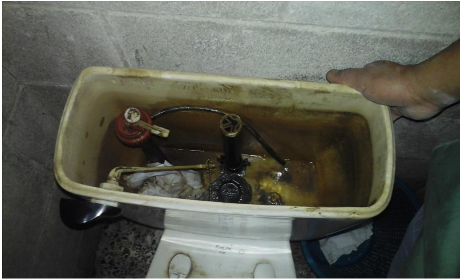
Depósitos de sanitarios en mal estado.
