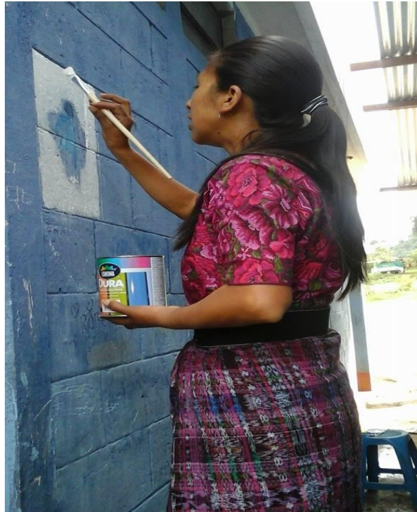
Se esta pintando la pared para la rotulación e identificación de los sanitarios para varones y señoritas.
