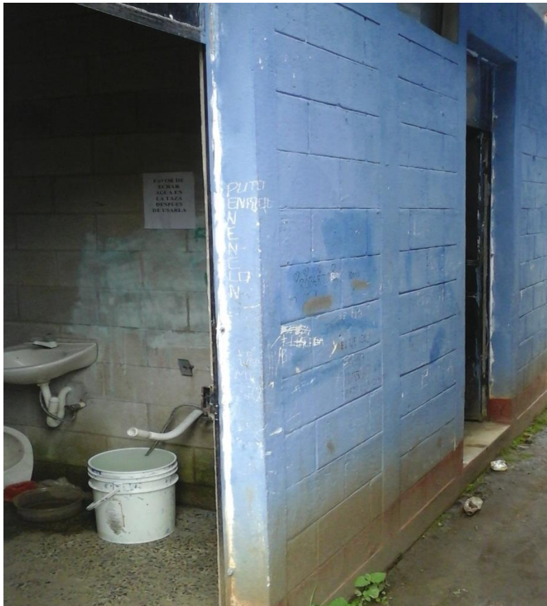
Lavamanos dañados por lo que los estudiantes no pueden ser utilizadas.
