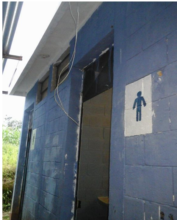
Sanitarios con la respectiva identificación.
