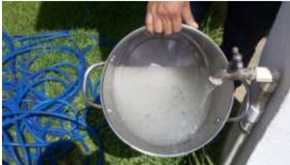
Fuente: Imagen de una de las tomas de agua, que muestra el mal estado de las tuberías de las instalaciones de la Asociación Rosas de Amor.
